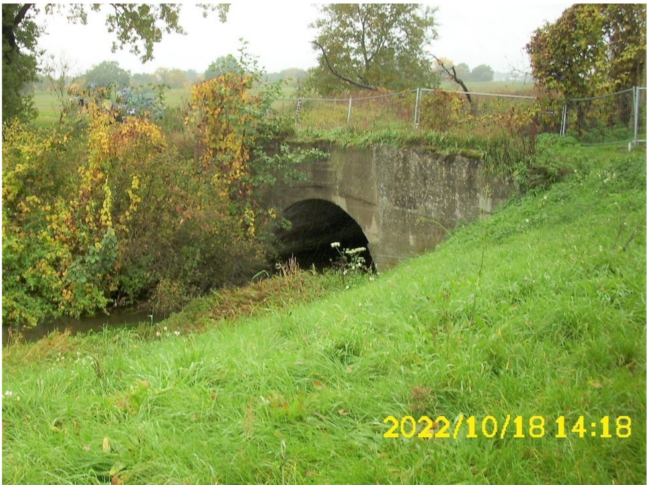
Abbildung 1 – beschädigte und gesperrte Brücke über das Buderoser Mühlenfließ
